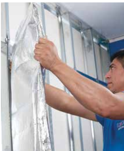
• Instalación Prodex Híbrido
